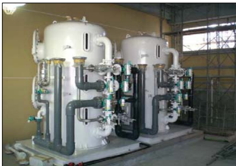
純水製造装置
