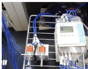
リレー動作制御用 シーケンサー
